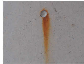
Der verursachende Pyriteinschluß ist entfernt
