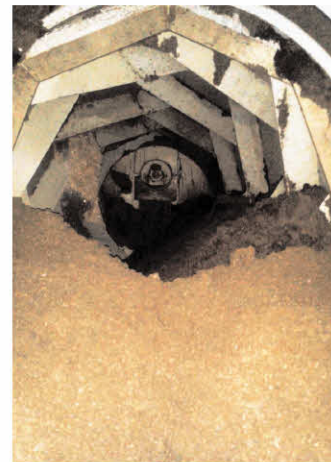
unter Extrembedingungen: mit Gärresten überfüllte Mineralit - Trommel
